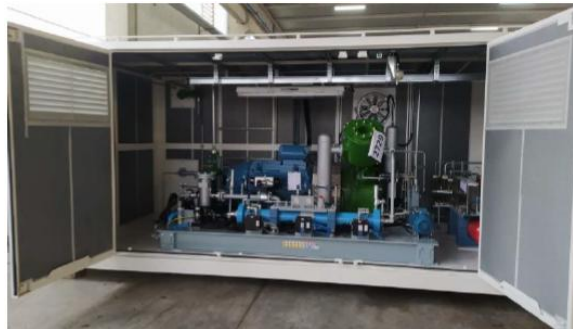
6 pav. Kompresoriaus konteineris
